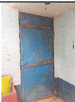
Foto 5: Estado actual de puertas
