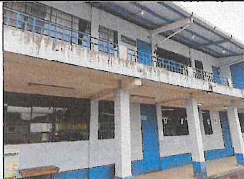
Foto1: Estado actual de la pintura del centro educativo
