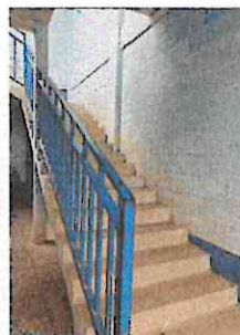
Foto 4: Estado pintura de barandas
