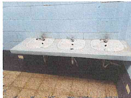
Foto 2: Grifos y llaves de paso en mal estado
